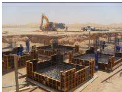
Centre de traitement des hydrocarbures à Rhourde Nous en Algérie
