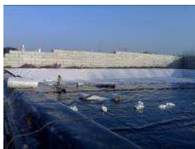
Bassin de rétention et confinement imperméabilisé « géomembrane » pour Coenmans à Béthune
